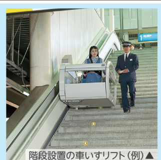
階段設置の車いすリフト(例)▲
